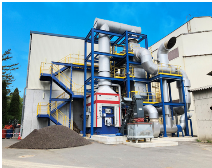
バイオマス熱風炉
