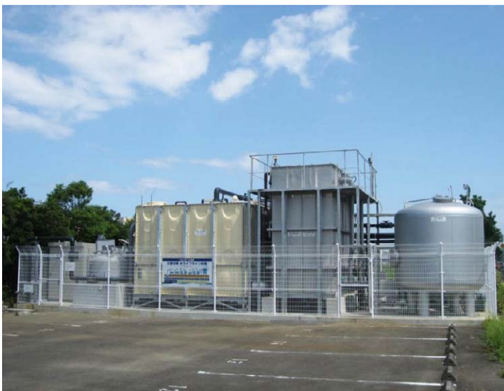
地下水膜ろ過システム
