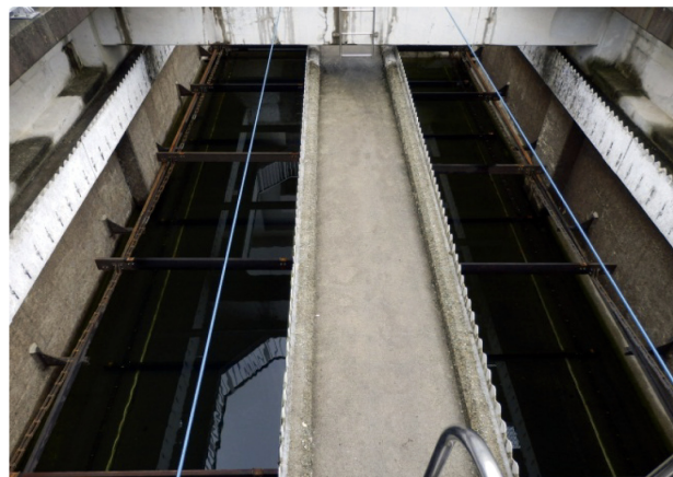
沈殿槽の様子 浄化センターにて
