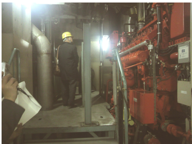
稼働中の消化ガス発電機
