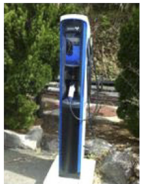
EV車用充電器
