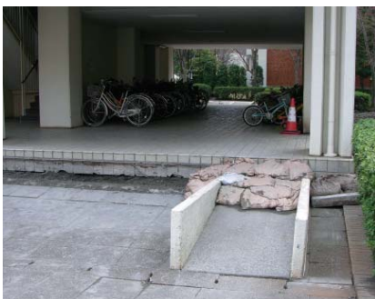
建物の周りに出来た段差
