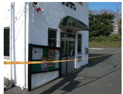
沈下して傾いた交番
