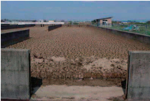
図1 古典的な天日乾燥床による上水スラッジの脱水
