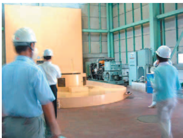
柚木発電所 発電室
