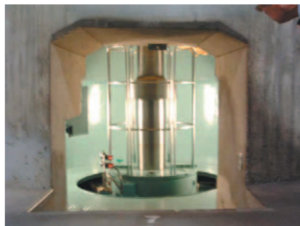
柚木発電所 発電機
